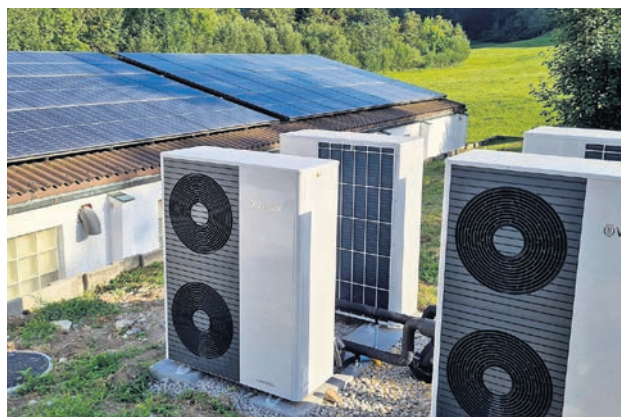
La propre centrale électrique de l'entreprise sera complétée par une batterie de stockage domestique. Photo: mäd
