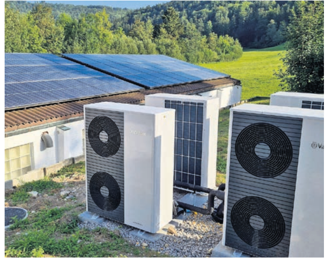
Das hauseigene Kraftwerk wird durch einen Batteriespeicher ergänzt.
