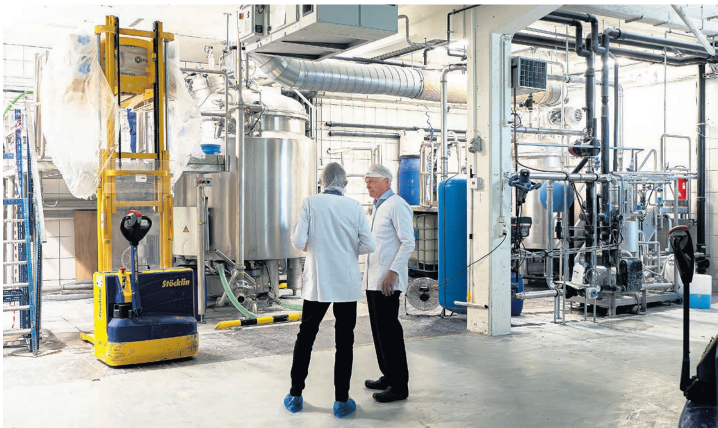
L'un des deux nouveaux mélangeurs. Coût d'acquisition: 800000 francs chacun.
