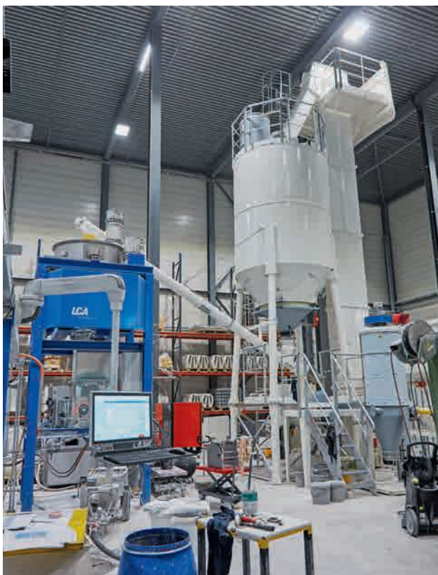
Unten: Das Silo ist eine Eigenentwicklung der Affentranger Bau AG.
