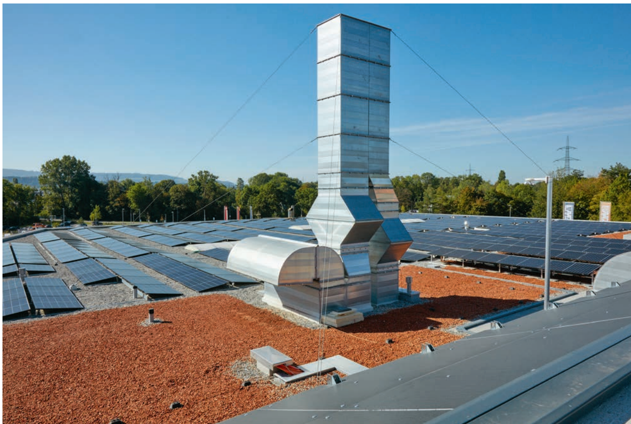
Die Photovoltaikanlage wird ihre definitive Dimension erhalten, wenn auch das dritte Parkdeck überdacht ist.
