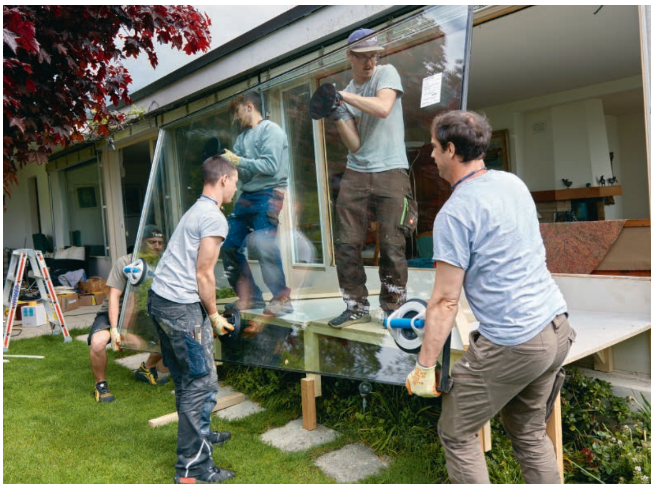
Eine Fensterscheibe, die Kraft von fünf Schreibern bzw. Auszubildenden: Energetische Massnahmen sind «gewichtig» – und auch auf die Rosen muss Rücksicht genommen werden.
